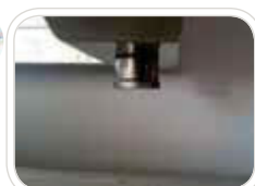
Σωλήνας απομάκρυνσης λαδιού
